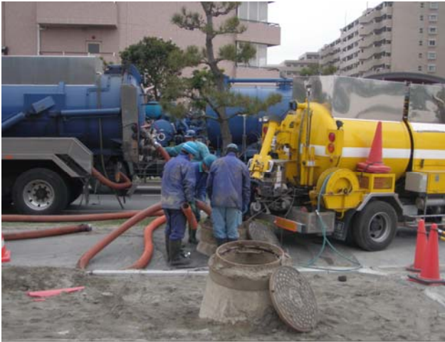
隆起したマンホール
