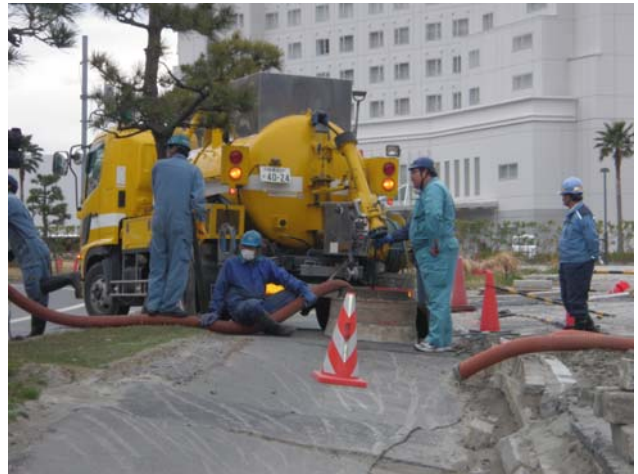
地割れや波打つ歩道
