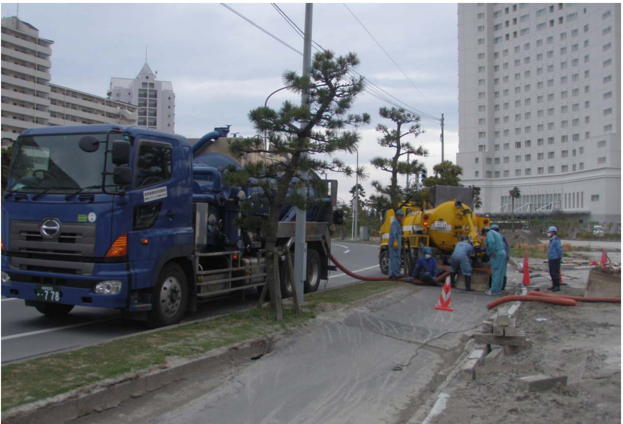
地盤沈下した歩道
